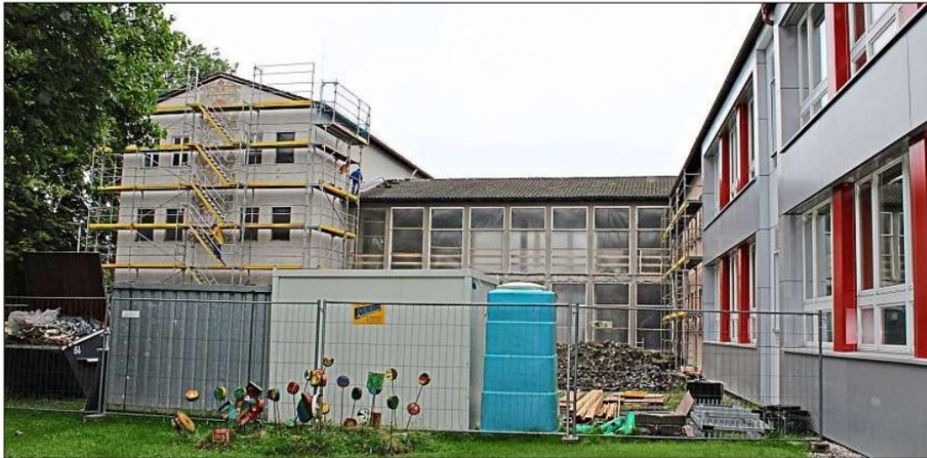
Während der Ferien kann unter Hochdruck an der Heinrich-Braun-Mittelschule gearbeitet werden, ohne dass Schüler gefährdet oder beeinträchtigt sind. Der Klassenzimmertrakt im Westen (rechts) wurde bereits saniert und sauber verkleidet. Das Sgraffito an der Stirnseite des alten Gebäudes (links) soll auf der neuen Fassade rekonstruiert werden. – Fotos: luh
