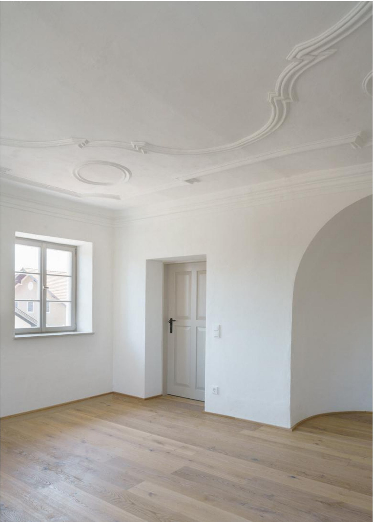
In den Räumlichkeiten im 1. Obergeschoss des Bestandsgebäudes wurden die Stuckdecken restauriert und ursprüngliche Deckenbemalungen teilweise freigelegt. (Foto: Sebastian Schels)
