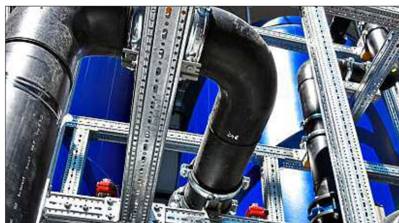
Adsorber, Tanks und Filterstraßen arbeiten im Inneren der Anlage perfekt aufeinander abgestimmt.
