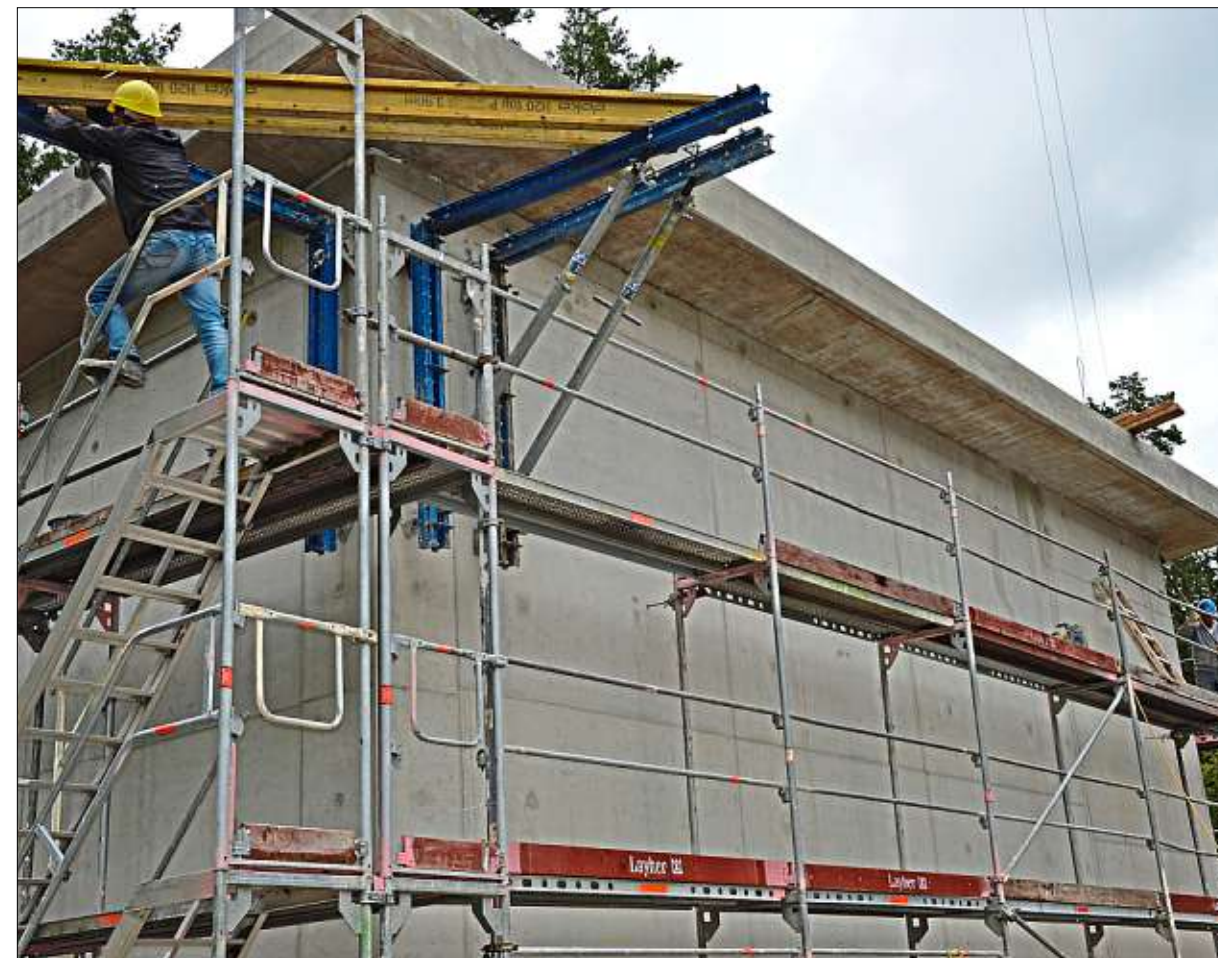
Der Rohbau für die Anlage zur Enteisenung und Entmanganisierung wurde gestern fertig. Die Arbeiter bauten gestern das Gerüst ab. – Fotos: Gerlitz
