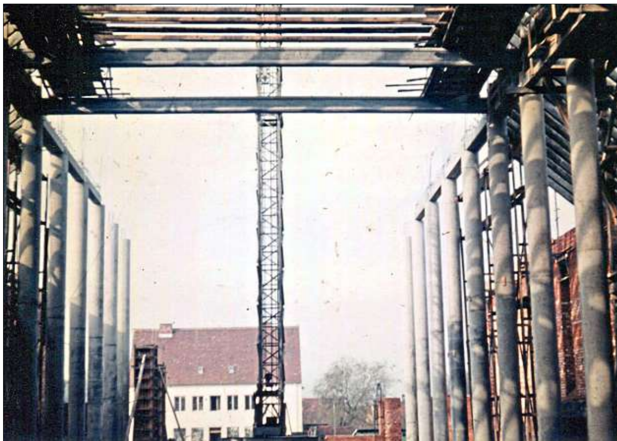
Aus der Bauzeit der Piuskirche stammt dieses Bild. Die Betonsäulen stehen bereits. Eine Säule kostete rund 1000 DM, weiß Kirchenpfleger Johann Fischer. Einige Bauern spendeten jeweils den Geldbetrag für eine Säule und leisten damit einen „tragenden“ Beitrag zum Kirchenbau. – Foto: ANA-Archiv
